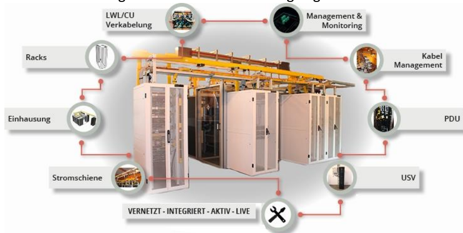
Bild 2: Beispiel für die IT- und Versorgungsausstattung eines Edge DCs wie es Geiger in seinem Infrastructure Design Center in Irschenberg selbst betreibt. Quelle: Geiger
